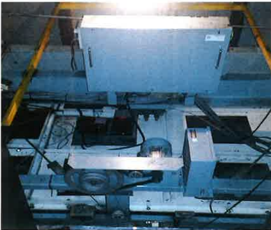
카 상부 전원라인및 청소 후
